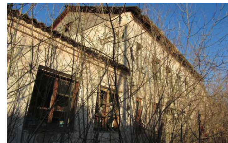
Заброшенное здание бывшей общественной бани снижает общую безопасность и привлекательность этого района города
