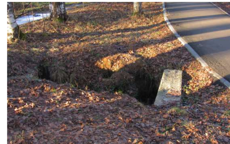
На территории имеются опасные участки с провалом грунта
